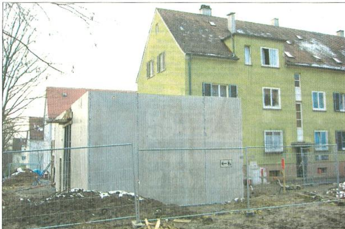
Die Wohnungen der Landes-Bau-Genossenschaft in Kornwestheim sollen zentral über eine Pelletanlage mit Heizenergie versorgt werden. Bild: privat
